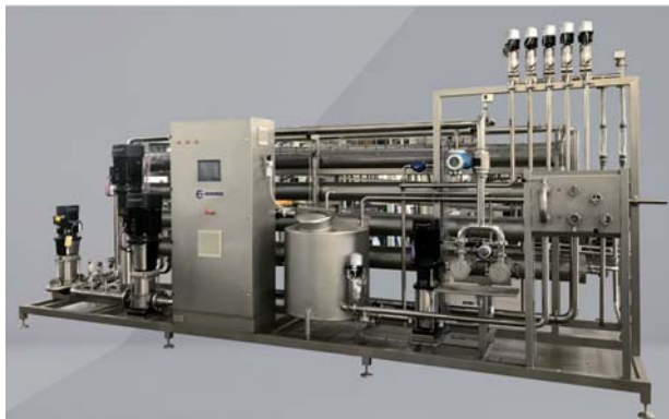
Figura 4 - Equipo de filtración por membranas
